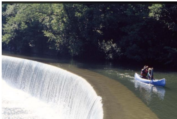
Photo : un ouvrage non franchissable
