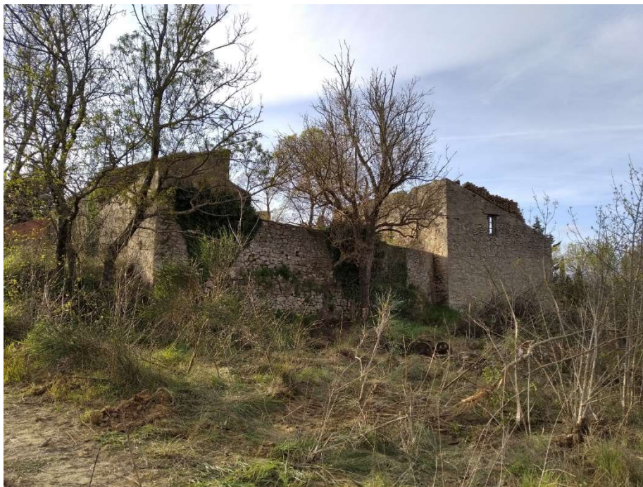
Métairie des Mouleyres, bâtiments ruinés.
