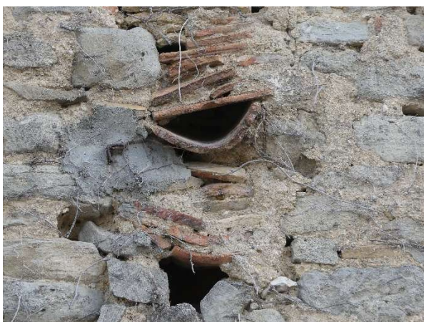
Sortie d'évier, maison 3 place de la Fontaine.
